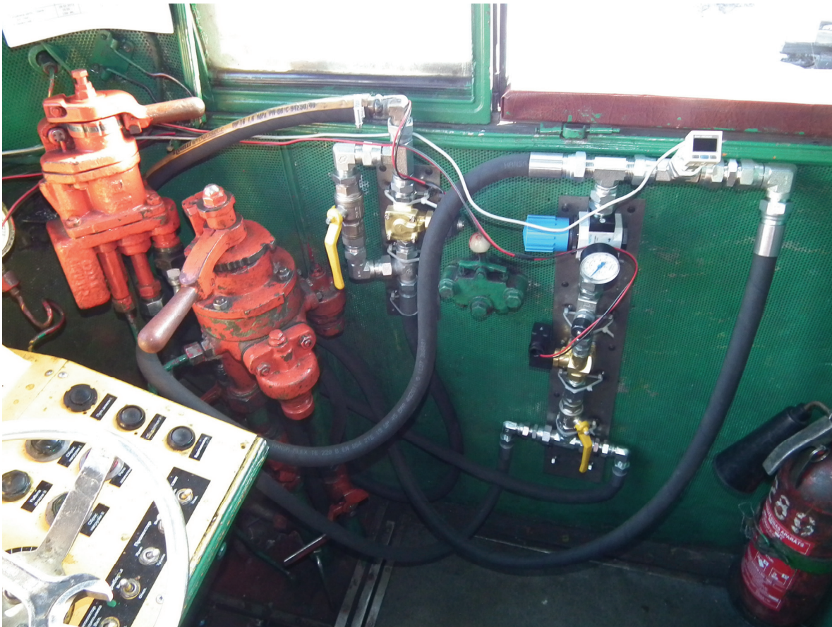
4.12. att. SAFE-R 5 iekārtas prototipa pneimatiskās daļas pieslēgums lokomotīvē M62
