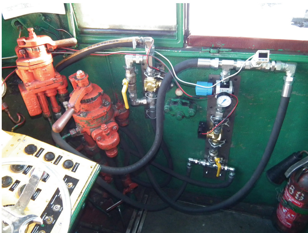
17. att. SAFE-R 5 iekārtas prototipa pneimatiskās daļas pieslēgums lokomotīvē M62
