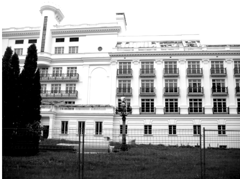
3. att. Ķemeru viesnīcā rekonstrukcijas laikā netiek padomāts pat par jumta seguma nomaiņu 2006. gada maijs.
