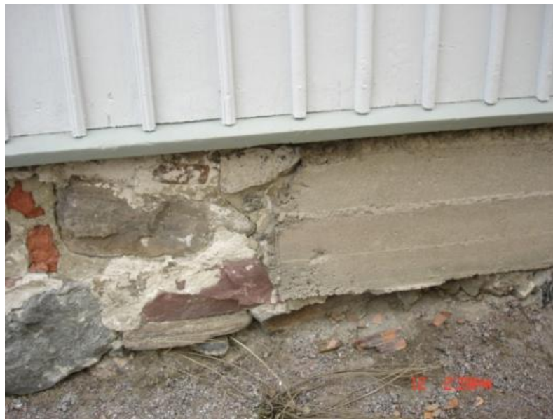
3. att. Ēkas pamatu vēsturiskais mūrējums un ēkas īpašnieka pamatu stiprinājuma risinājums ar cementa javu, kas nav pieļaujams vēsturiskām ēkām Fig. 3. Historical masonry of basement and basement fastening with cement mortar
