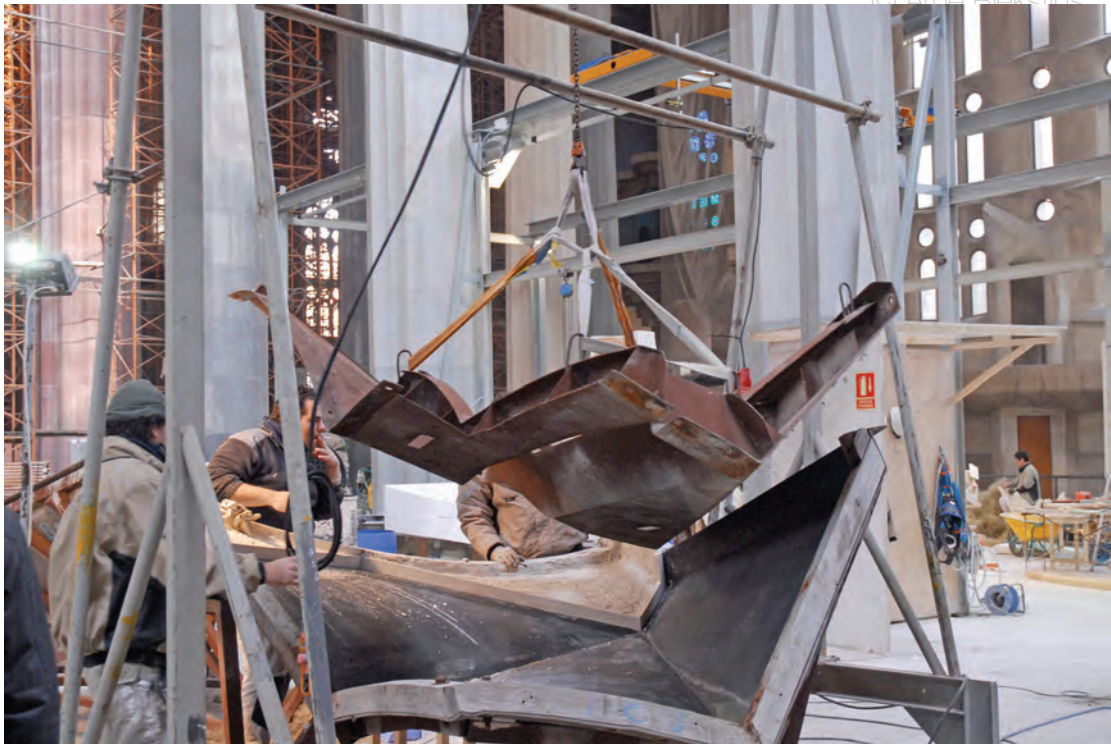
2.6. att. Fantastiskas konfigurācijas metāla armatūra tiek ievietota veidnī, kur pēc brīža tiks atliets vēl viens oriģināls baznīcas būvelements. [A.R.]
