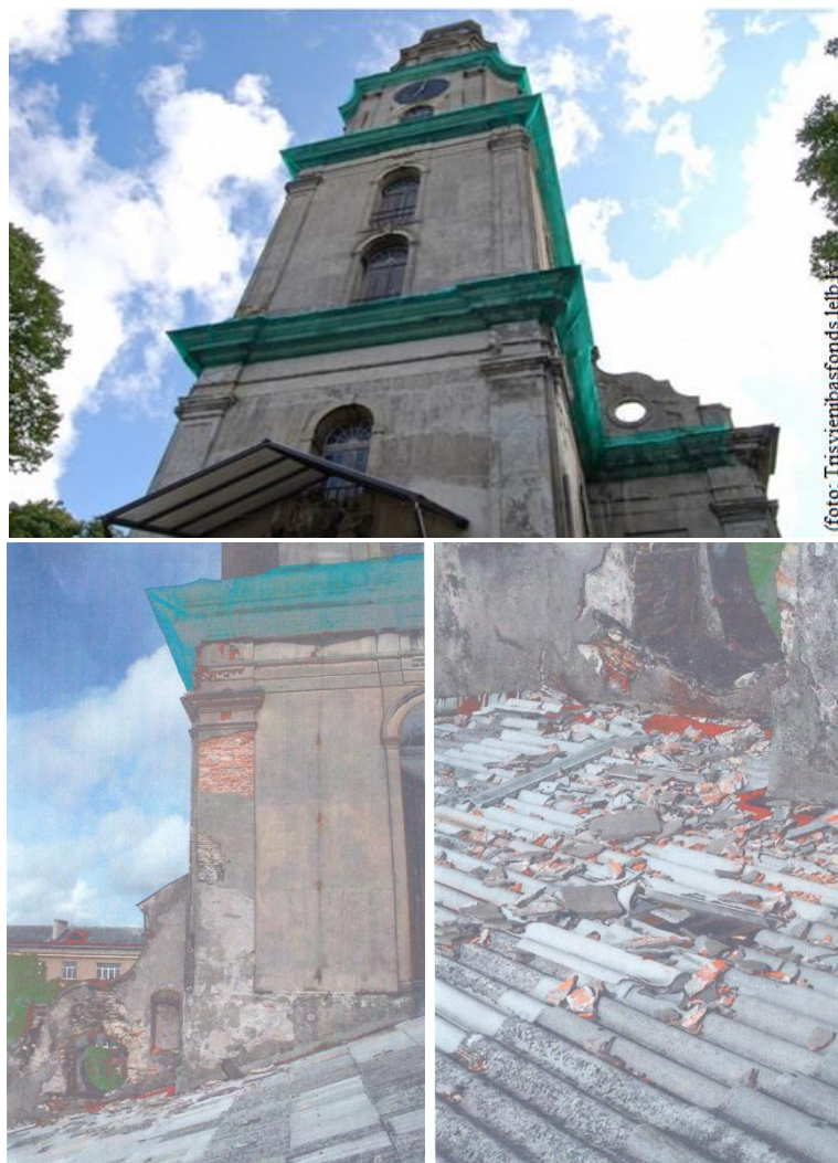
1.2. attēls. Liepājas Sv. Trīsvienības baznīca – cementa javu izmantošanas kaitējums (2012. g.).
