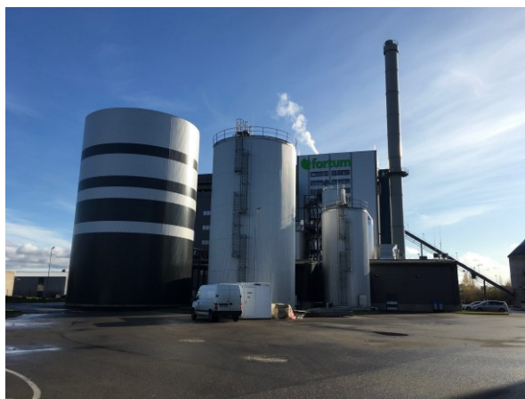
2.12. att. Siltumakumulācijas tvertne Jelgavā
